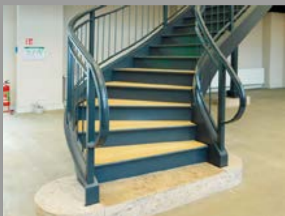
Der Handlauf führt nicht bis zur letzten Stufe, außerdem ist der Treppensockel noch eine weitere Gefahr, da er sich nicht kontrastreich vom Bodenbelag absetzt.
