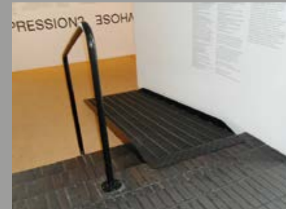
Die Stufen sind mit einer Sehbehinderung fast nicht erkennbar.
